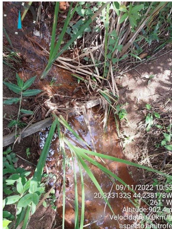
Figura 8.6- Ponto de lançamento de esgoto na área do Parque
